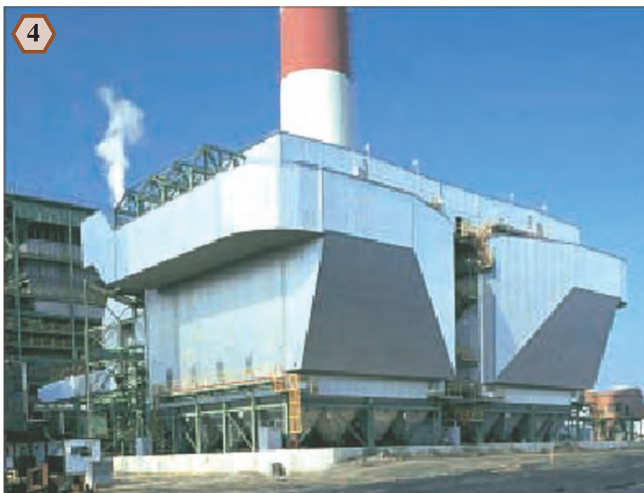
Précipitateur électrostatique moderne d'une centrale thermique au charbon de 320 mégawatts. Après avoir transité dans le précipitateur, les gaz sont dirigés dans la cheminée. On voit bien les entonnoirs de récupération au bas de l'installation (gracieuseté de Wheelabrator Air Pollution Control inc., Pittsburgh, PA, USA).
