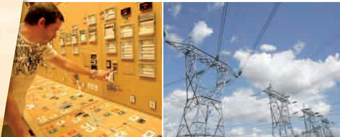
Salle de commande et lignes électriques de la centrale nucléaire de St-Alban sur le Rhône (2 × 1300 MWe).
