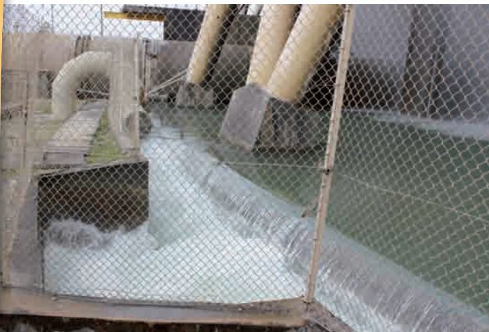
Purge d'un aéroréfrigérant
