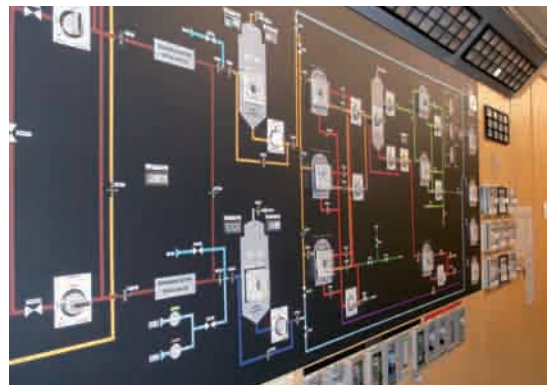
Salle de commande du Traitement des Effluents Primaires TEP : centrale du Bugey
