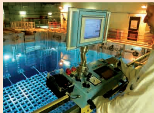
Piscine de désactivation du combustible usé à la centrale de St-Alban. La piscine où le combustible usé séjourne pendant plusieurs années avant d'être évacué à l'usine de retraitement, est équipée d'un circuit de refroidissement et de purification qui lui est propre.
