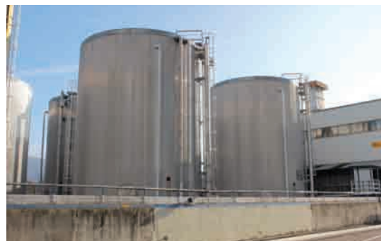
Réservoirs T et Ex d'entreposage des effluents avant rejet et leurs cuvelages de rétention : centrale du Bugey.
