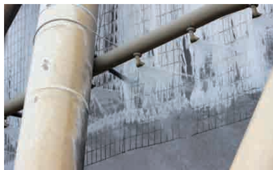
Systeme de lutte contre la prise en glace d'un aëroréfrigérant
