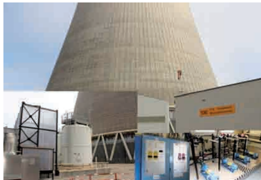
Traitement à la monochloramine à la centrale du Bugey
